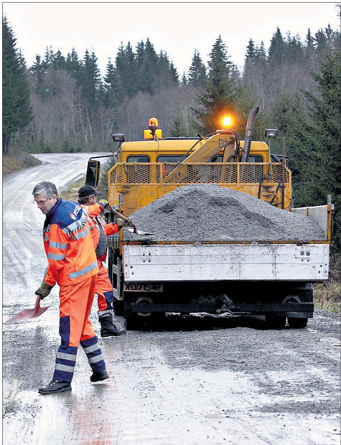
KREVENDE: Vedlikehold av veiene krever stadig større summer. At vi nå har tre-fire teleløsninger i løpet av en vinter, krever stor økning i vedlikeholdsbudsjettet, påpeker artikkelforfatteren. Likevel er det politisk utenkelig at vi ikke skal ha nye samferdselsprosjekter i Norge i kommende tiårsperiode slik NTP legger opp til. Illustrasjonsfoto.
